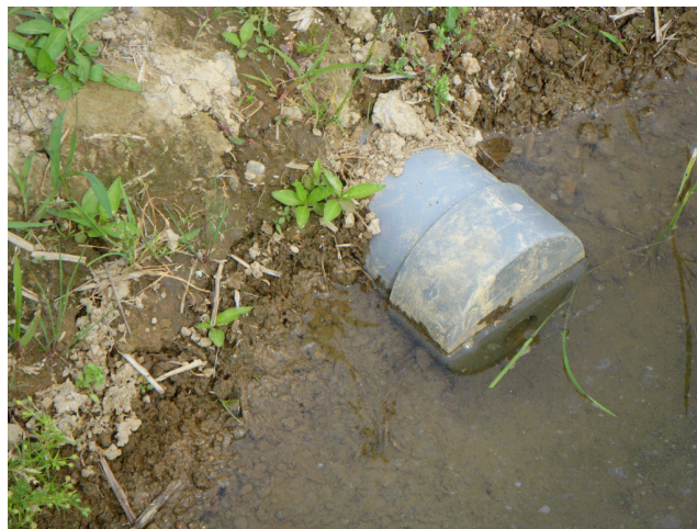
写真 2.5 落水量調整キャップ（新潟市横江地区）
