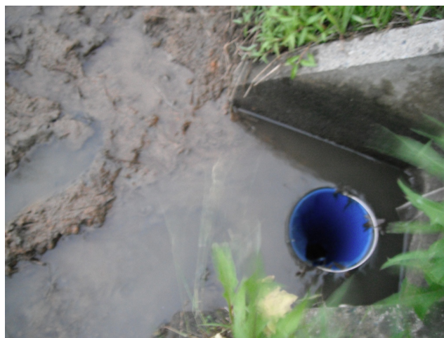
写真 2.8 機能一体型フリードレン調整管（見附市貝喰川地区）
