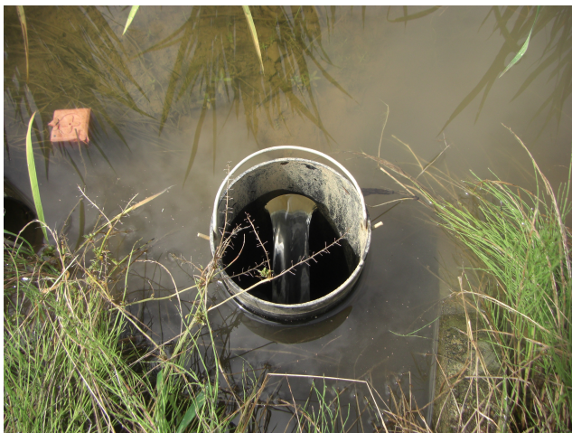
写真 2.3 機能一体型フリードレーン調整管（見附市貝喰川地区）
