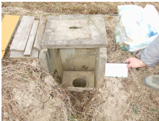
写真 2.1 水平設置型落水量調整板（村上市神林地区）
