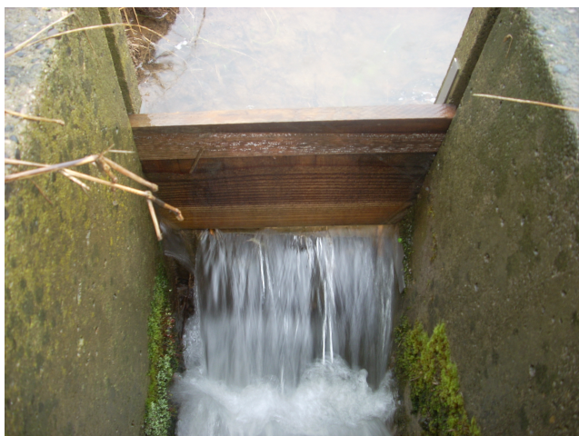
写真 2.4 落水量調整金具（新潟市白根郷地区）
