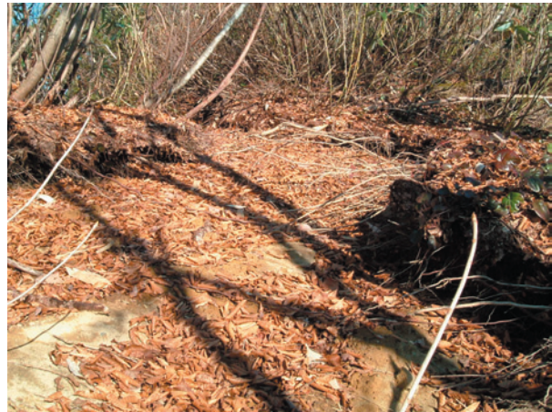
写真 21. 尾根上の亀裂（魚沼市広神地区一ッ峰沢）
