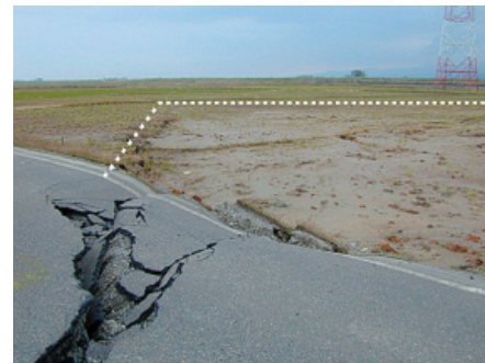
図8 連続する段差・亀裂2 段差・亀裂は農道を横断した後、右方向に直角に曲がる。
