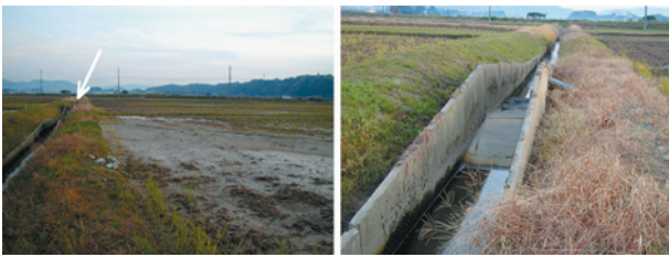
図10 段差・亀裂と排水路との交差点2 右の図は矢印で示した地点を拡大したもの。水路に変状が見られた区間は約20mにおよび、水路底は最大で約1m上昇している。
