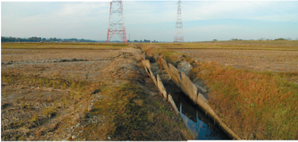
図9 段差・亀裂と排水路との交差点1 水路は段差・亀裂との交差点で激しく破壊され、その機能を完全に失っている。
