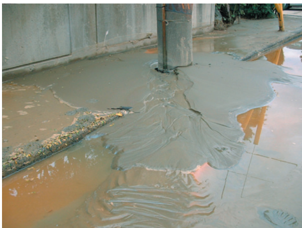
第5図.電柱の根元からの噴砂(南本町2丁目)
