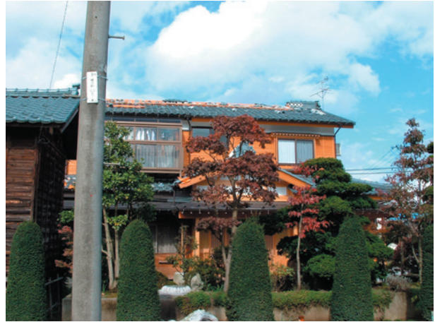
第11図. 棟瓦の落下した屋根（熱田町）
