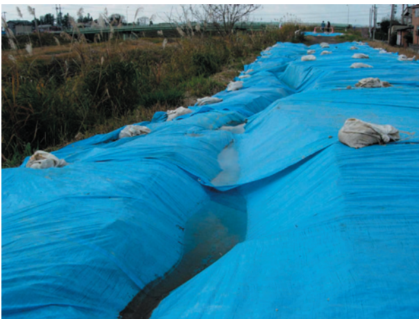
第10図. 大きく沈降した刈谷田川の堤防(南本町1丁目)
