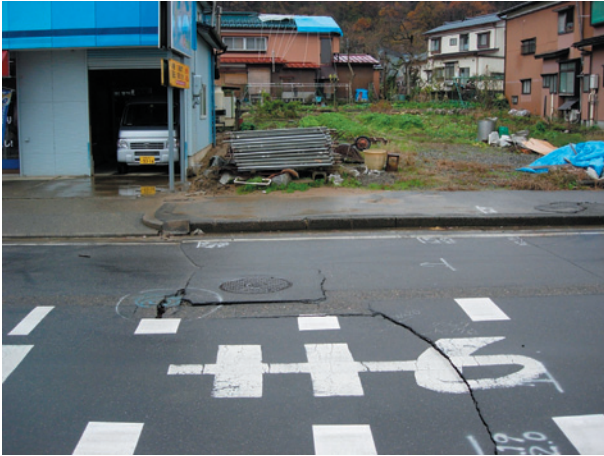
第9図. 道路に生じた亀裂（嶺崎1丁目）
