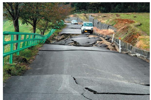
写真-11 第二調整地の山側盛土崩壊状況
