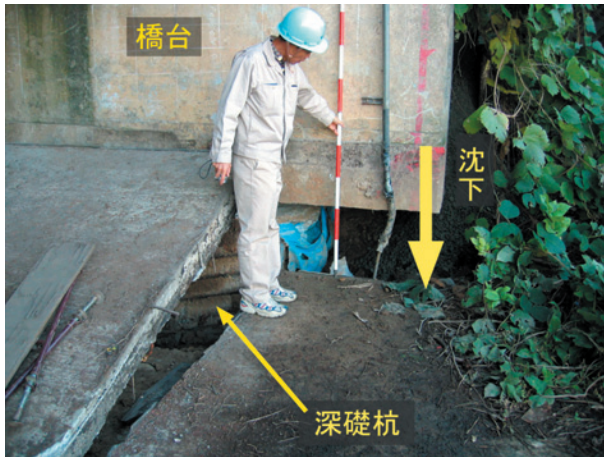
写真-8 国道 117 号山辺橋基礎の被害 (小千谷市)
