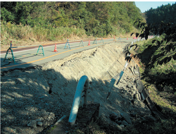
写真-10 道路盛土の崩壊例 (柏崎市)
