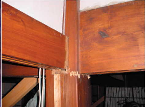
写真.26 大黒柱の折損 (No.5)
