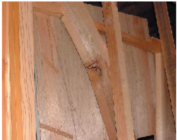
写真.11 筋かいの座屈（節の部分で座屈している）
