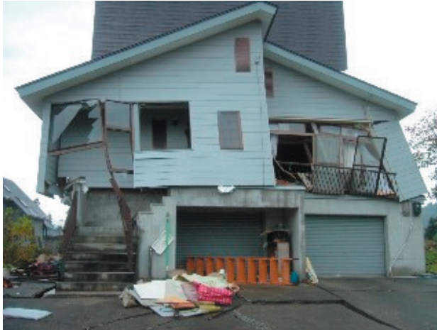
写真.2 大破した高床基礎の在来軸組住宅
