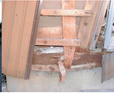
写真.13 釘打ち筋かいの踏み外し (土台等に腐朽が見られる)
