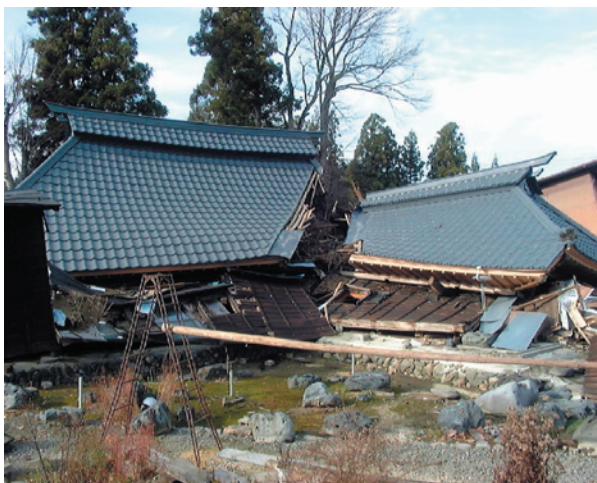
写真.4 伝統構法住宅の倒壊状況
