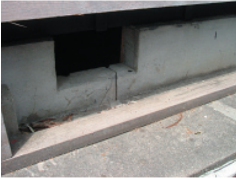
写真.24 布基礎の割れ (No.2)
