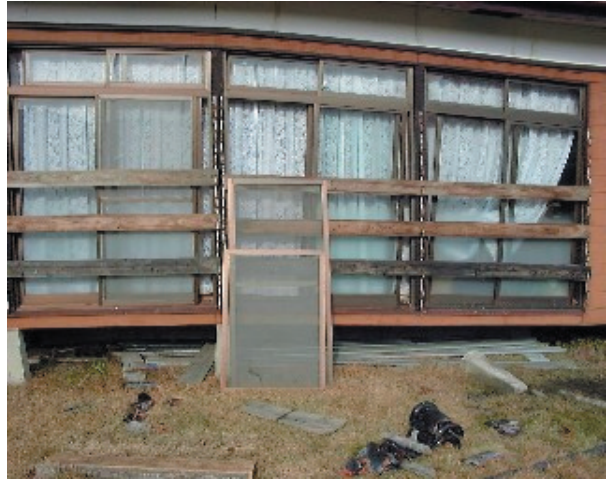
写真.7 独立基礎がはずれた例
