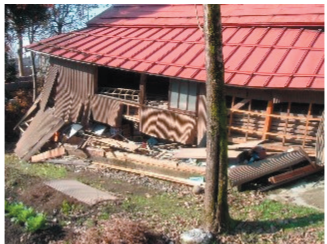
写真.5 倒壊した作業場
