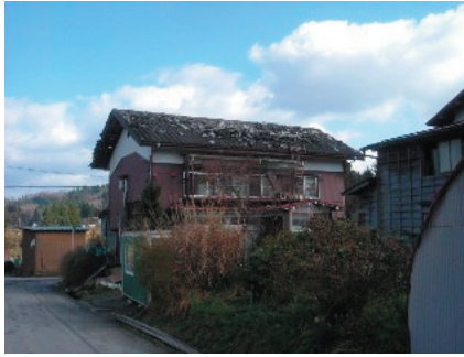
写真.12 瓦屋根の被害
