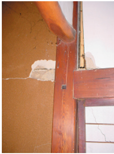
写真.28 込み栓における柱割れ (No.5)
