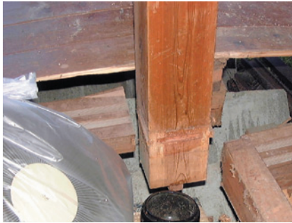
写真.15 土台と柱のずれ
