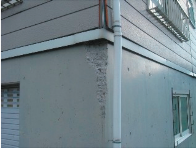
写真.6 基礎隅角部の圧壊
