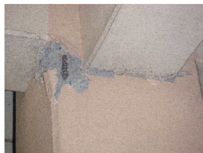
写真6 東小千谷中学校増築棟のピロティー柱の曲げ圧壊
