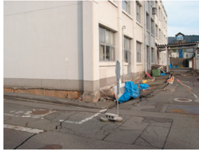
写真20 長岡工専3号館の地盤沈下による基礎の露出(右が崖地)
