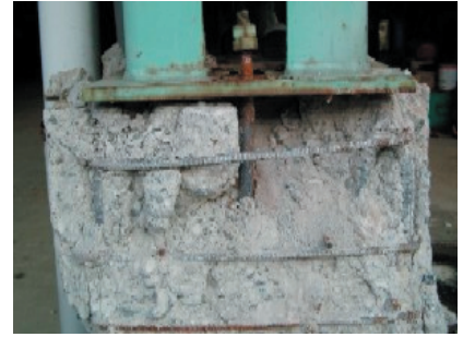
写真 33 長岡市の事務所兼住宅 (建物C)の柱脚の被害
