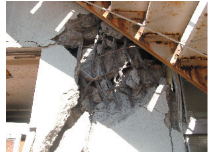
写真24 1Fの柱がせん断破壊し、軸耐力を失っている
