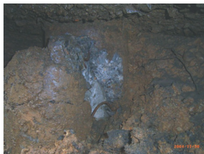
写真17 写真16部分を掘り出したところ、大きく破損していた。「横山光浩氏（細貝建築事務所）撮影」
