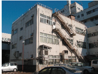
写真23 小千谷総合病院の北西側張り出し部分:1Fの柱がせん断破壊し、軸耐力を失っている。柱の詳細は次の写真。
