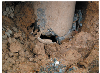
写真15 写真14の右の杭の詳細。PC杭でφ350。中空部とコンクリートが充填してある杭頭補強部の境でせん断破壊。
