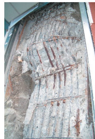
写真30 建物Bの柱のせん断破壊「梶井照仁氏(建構造研究所)撮影」
