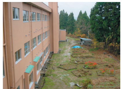
写真18 山古志中学校校舎棟の北面。向こう（西）側に向かって不同沈下が激しい。
