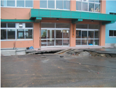
写真19 山古志中学校校舎棟の南面。左(西)側に向かって断続的に地盤沈下
