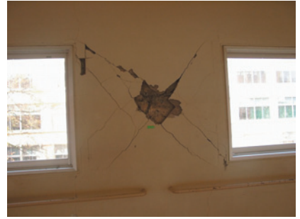
写真9 2F北側構面の柱のせん断破壊（IV）
