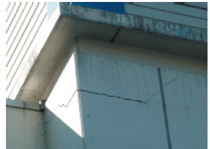
写真 36 川口小学校柱脚部コン クリート亀裂「福井工業大学 辻岡静雄教授撮影」
