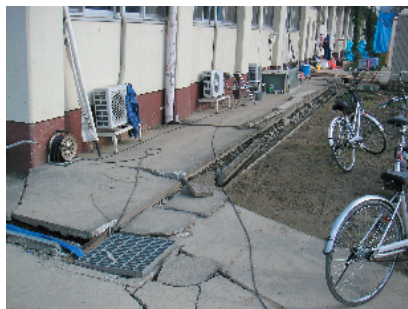
写真2 田麦山小学校の周辺地盤の変状
