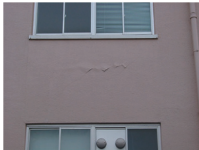
写真11 長岡高専4号館のはりの一方せん断ひび割れ
