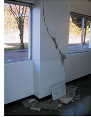
写真21 栃尾市東谷小学校の柱のせん断破壊
