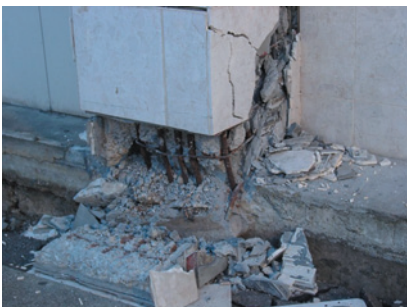
写真28 建物Aの柱脚の被害
