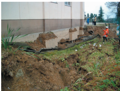
写真13 体育館棟の北側の崖が崩れ、北面の基礎が露出していた。杭はせん断破壊していた。ただし、体育館棟の傾きは少ない。
