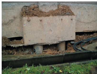
写真14 写真13の右から2番目の基礎。PC杭（350φ、中空（厚さ75mm）、軸方向筋6φ@130mm、横方向筋の径は約2.3mm）
