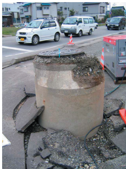
(5) マンホールの隆起
