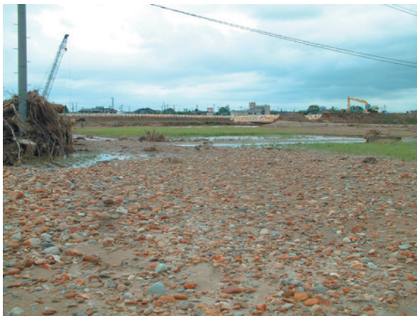
写真3 諏訪地点破堤跡に見られる石礫（破堤箇所が遠望できる。大熊撮影）
