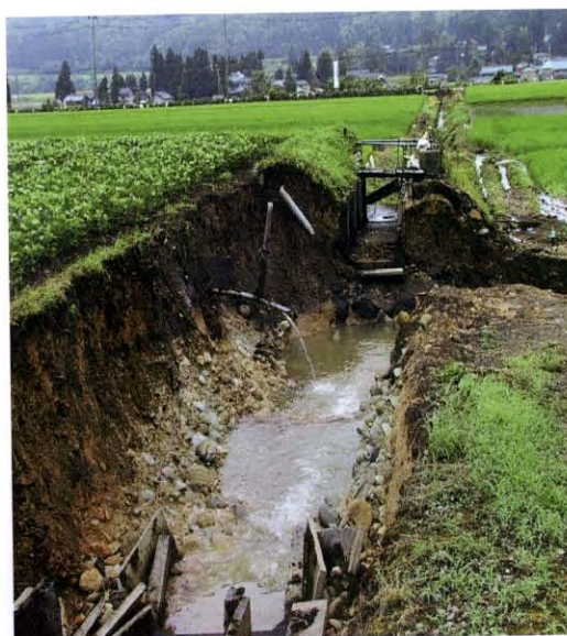
写真10 洪水により流された水路（下田村） (写真提供：三条農地事務所)
