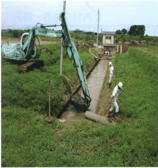
写真11 流入した土砂の排除（田上町） （写真提供：三条農地事務所）
