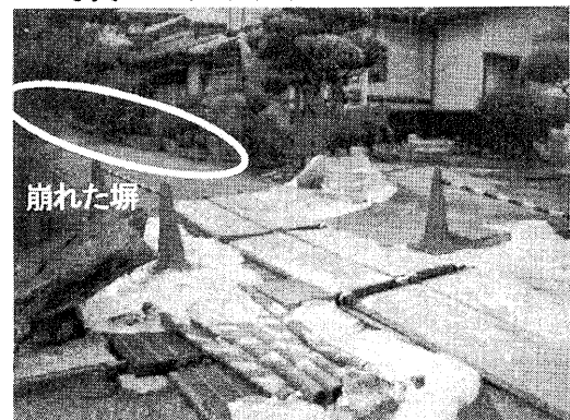
写真4 柏崎市西山町周辺 地盤変状と塀の転倒
