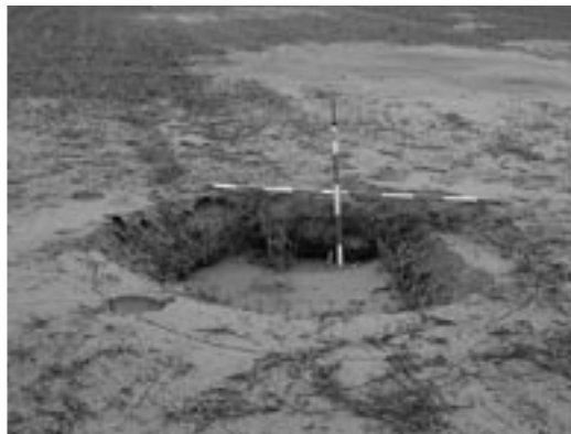
図-3 円形状の陥没 砂・水の噴出により、直径3m、深さ0.6mほどの陥没が生じている。
