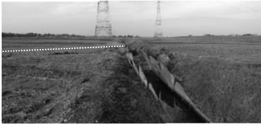
図-8 段差・亀裂と排水路との交差点①
