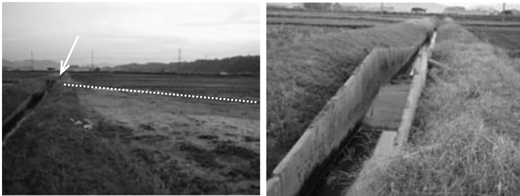
図-9 段差・亀裂と排水路との交差点②
