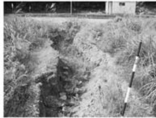
(b) 壊滅的な損傷を受けたため池 208-21 (b)
