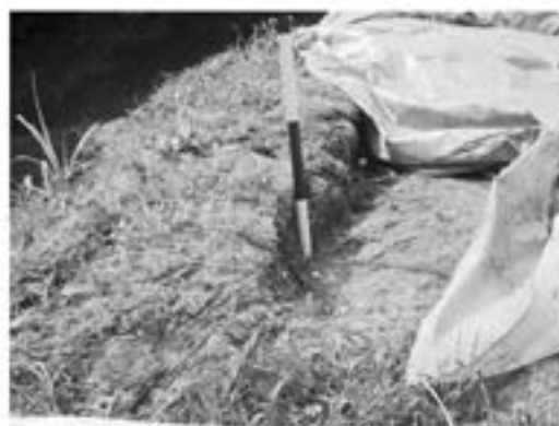
(b) やや重度の損傷を受けたため池 215-367
