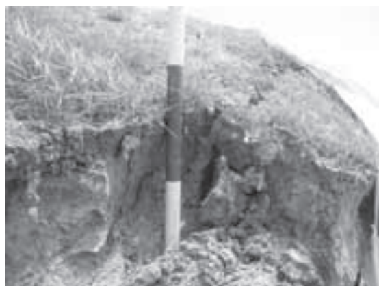
図1 No. 1地点における堤防法面の損傷状況
