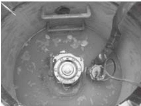
図11 充水中に発生した空気弁下部での破損事故 (25号空気弁工)
