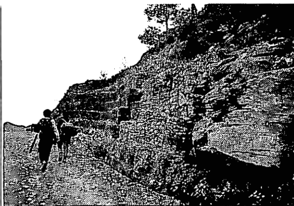
写真-5 ドゥンチェーカリカサン間に見られ た地すべり対策工 (1987年8月11日)
