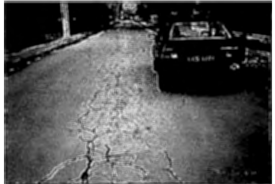
写真-9 凍上による道路被害(クラコフ市内)
