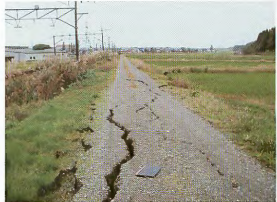
写真-6 JR線, 線路脇の未舗装道路上の亀裂.
