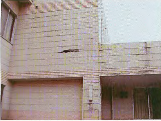
写真-1 六日市町コミュニケーションセンター(2FRC).1・2層階境界部の外装のはがれ.
