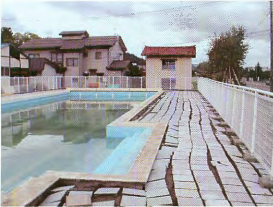
写真-3 六日市小学校プールの変状.
