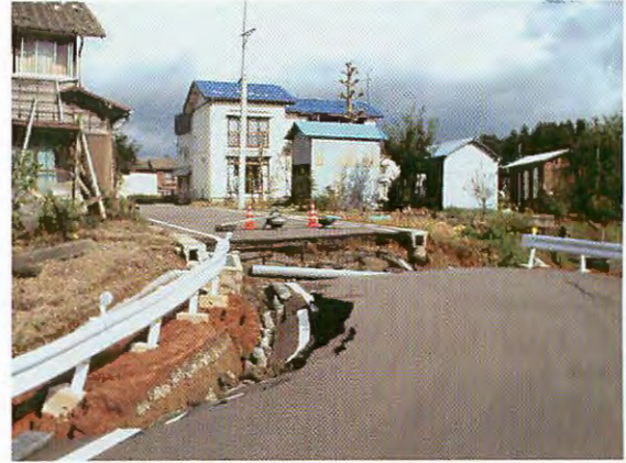
写真-4 道路盛土の崩壊. 沢部の盛土の崩壊とみられ, 地下水の湧出が認められる.
