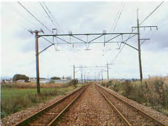
写真-5 JR線, レールの変形.
