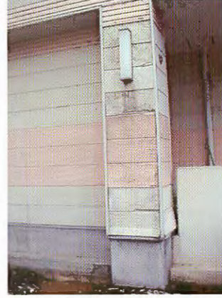
写真-2 六日市町コミュニケーションセンター(2FRC).支柱の外装のはがれ.
