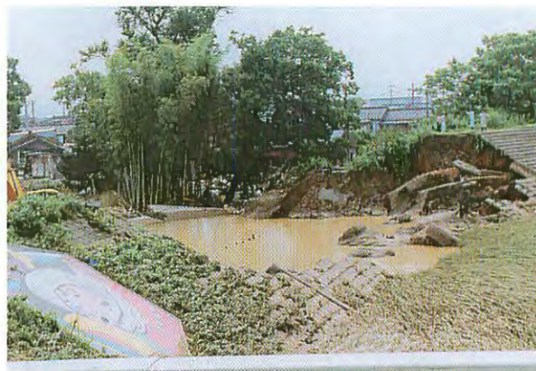
写真-2 破堤直後の堤防の状況 写真手前が刈谷田川. 7月14日撮影.
