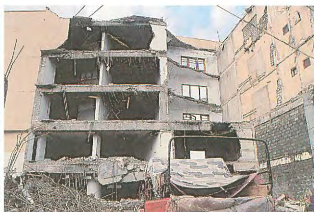
写真2 ムザファラバード市街地のビル倒壊状況
