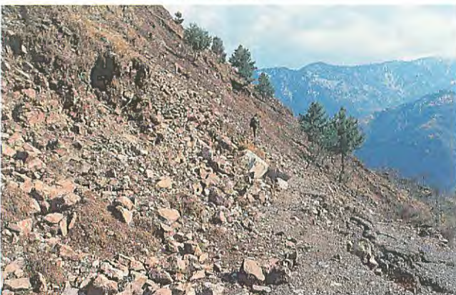
写真-7 チッカール村からハッティアン地すべりに向かう林道沿いの崩壊
