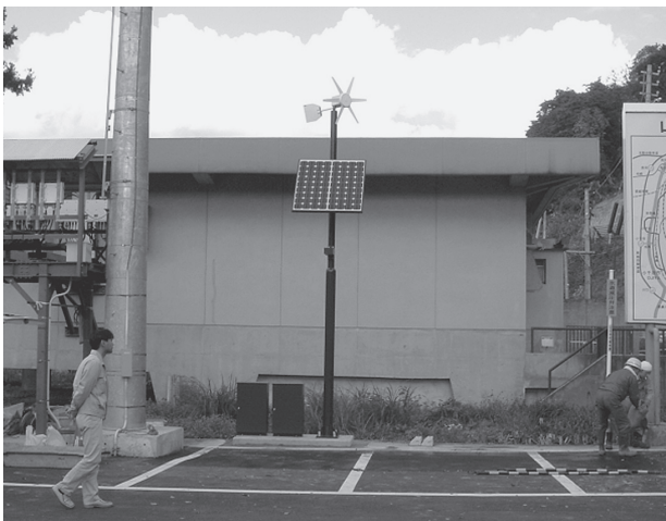
写真－3 山古志支所前防災照明
