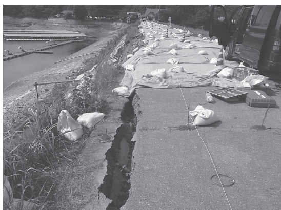
図1 A池堤体部の損傷状況（2011年7月）
