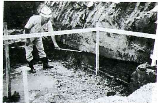
写真-1 付替水路構造物掘削により発生したすべり面
