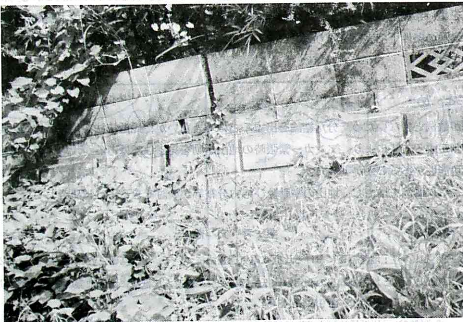
同上擁壁の亀裂発達上部の境界ブロック塀に発生した亀裂
