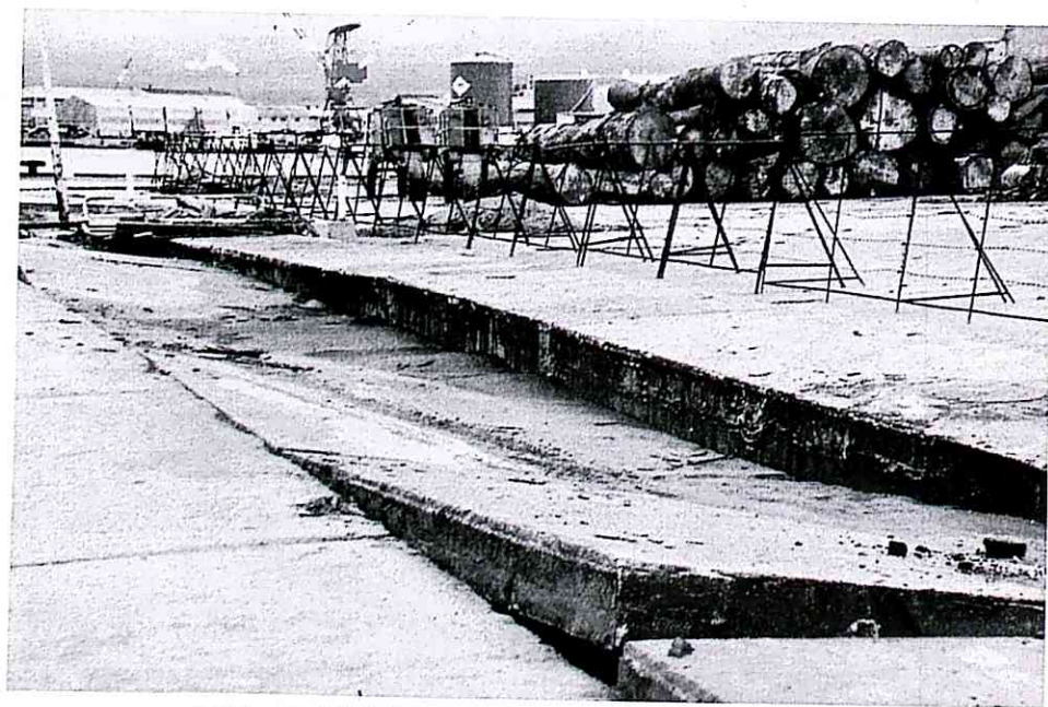
写真-2 函館港万代埠頭、エプロン背後の沈下と段差
