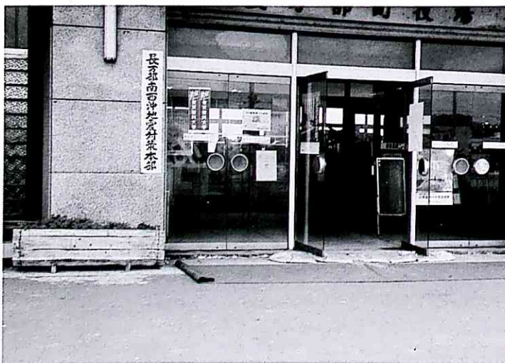
写真-10 役場入口の段差
