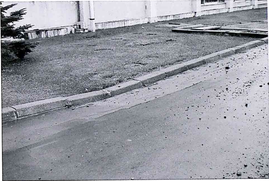
写真-6 文化センター、噴砂と通路沿いの変形
