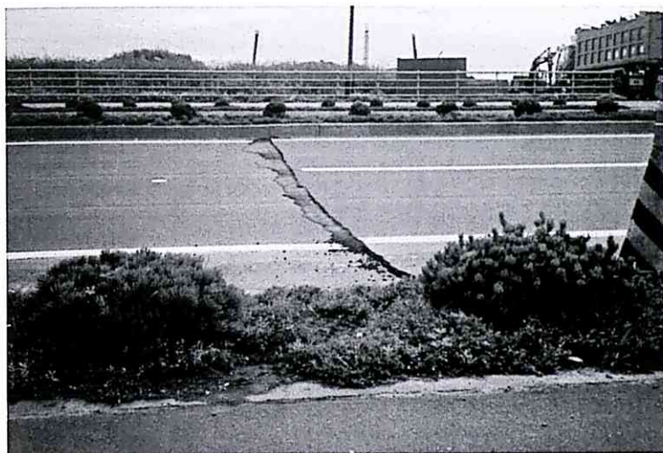
写真-15 国道5号線山崎橋より国縫方向200m間の道路波状変形 (北海道開発コンサルタントによる)
