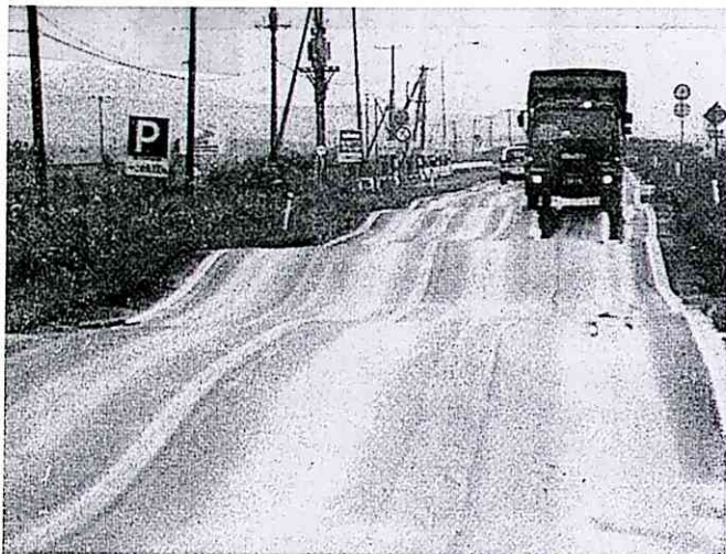
写真-18 国道5号線の車道の波状変形（北海道新聞による）
