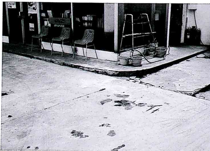
写真-20 国道わきガソリンスタンドの破損
