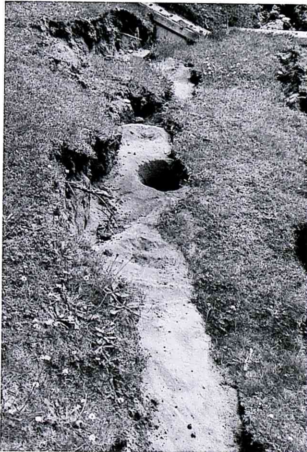
写真-33 用水路の閉塞状況
