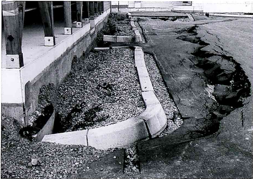
写真-29 校舎北側の沈下と開口クラック
