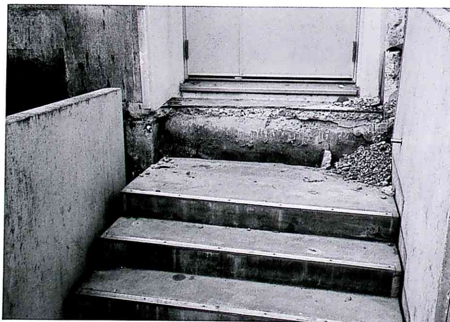
写真-25 体育館階段の沈下と破損
