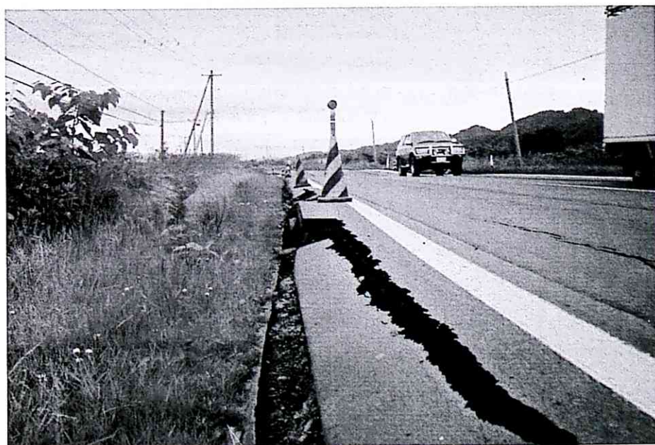
写真-11 豊津付近より長万部側に向かって4 km間の国道5号線路肩の沈下および車道のクラック
