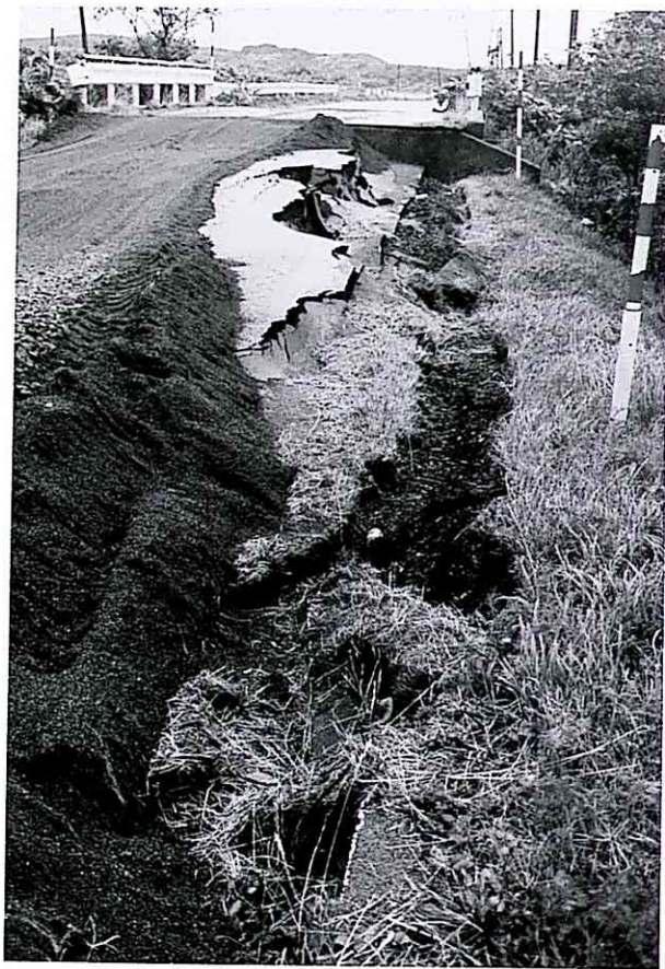
写真-18 兜野、町道車道及び路肩の崩壊
