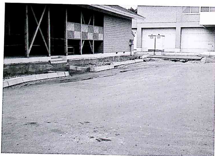
写真-21 前庭アスファルト舗装部の陥没
