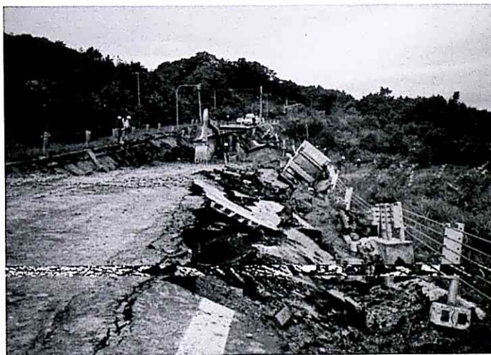
写真-16 国道5号線丘陵部に取りつく高盛土道路の崩壊
