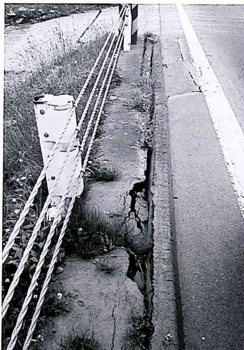
写真-4 国道5号線（黒松内～長万部間） 防護柵の変状及び路肩のクラック
