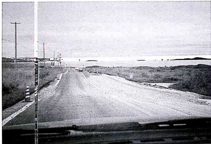
写真-13 国道5号線山崎橋より国縫方向200m間の道路波状変形 (北海道開発コンサルタントによる)
