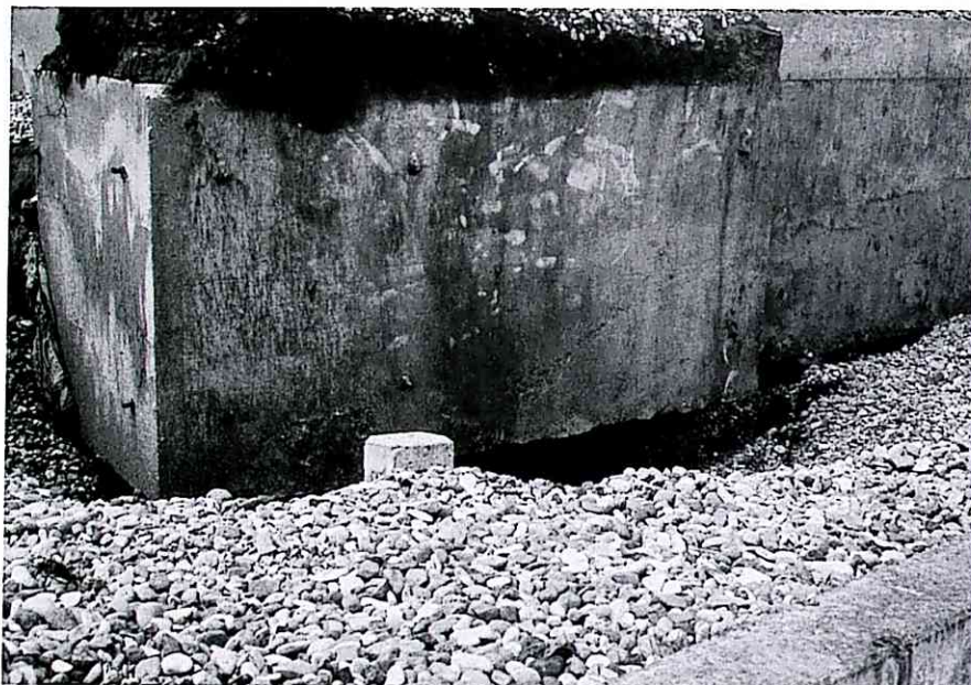
写真-24 周囲盛土地盤の沈下、水平移動により基礎の露出
