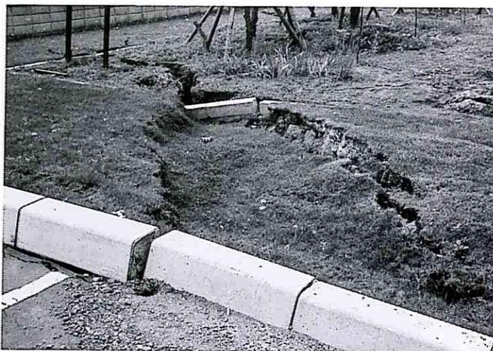
写真-1 前庭花壇のクラックと陥没
