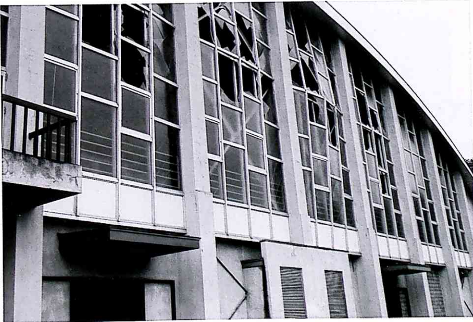
写真-7 文化センター、体育館ガラス枠のはらみ出し
