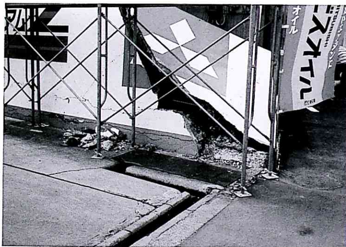
写真-19 国道わきガソリンスタンドの破損
