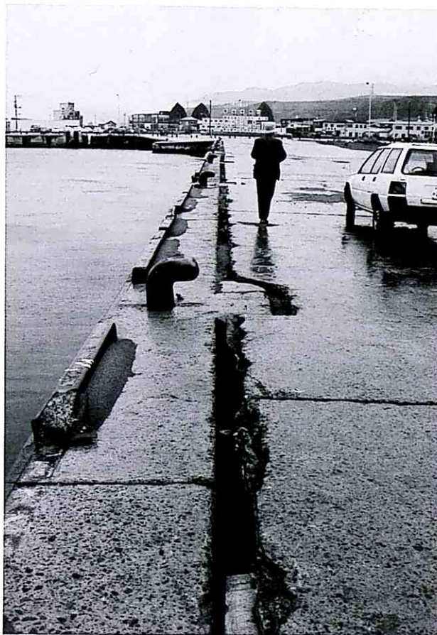
写真-1 瀬棚港エプロンの擁壁前倒しによる開口
