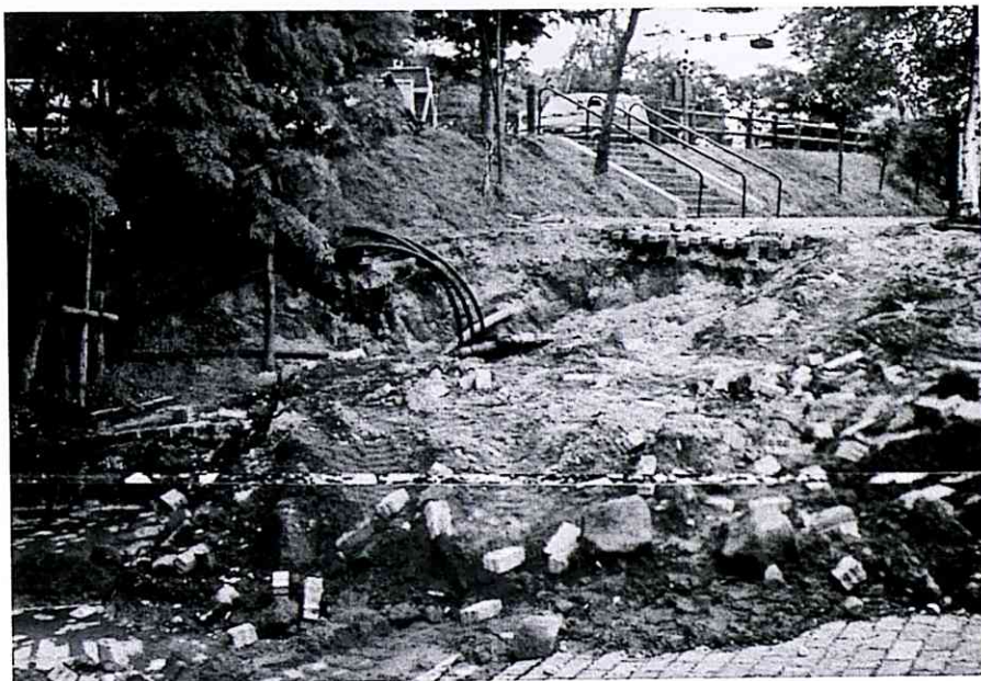
写真-1 大沼公園鹿部線の道路陥没（北海道開発コンサルタントによる）
