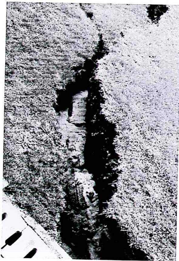
写真-35 グランド北側の開口クラック
