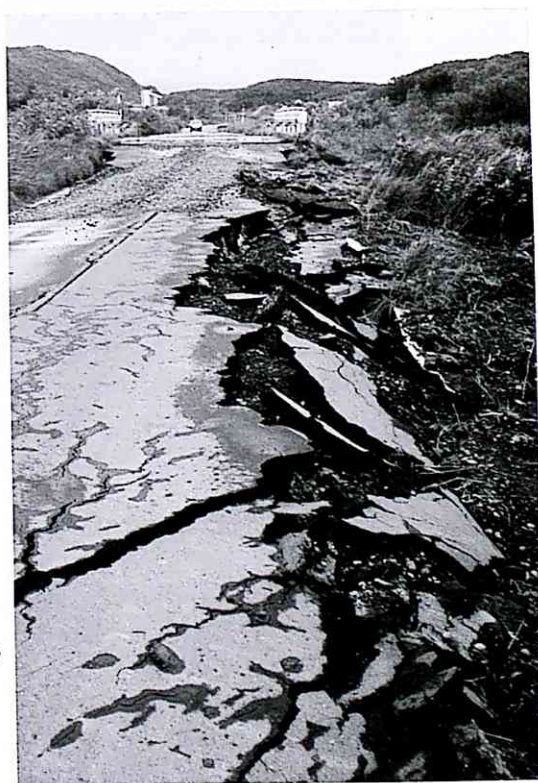
写真-17 兜野、車道及び路肩の クラックと崩壊
