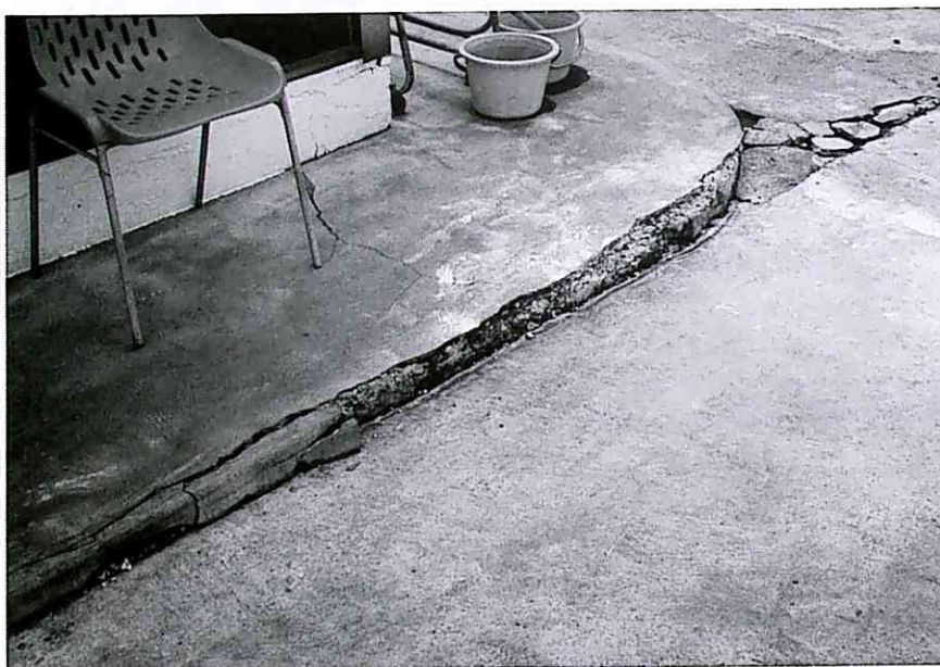
写真-4 5号線わき歩道の浮上り
