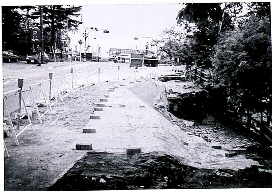
写真-2 大沼公園鹿部線の道路陥没（北海道開発コンサルタントによる）
