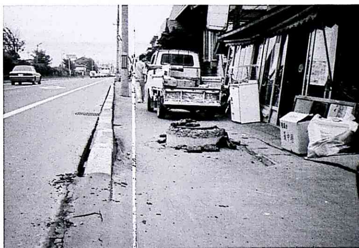
写真-2 国道5号線沿い縁石部のクラックとマンホールの30cm浮上り (同上)
