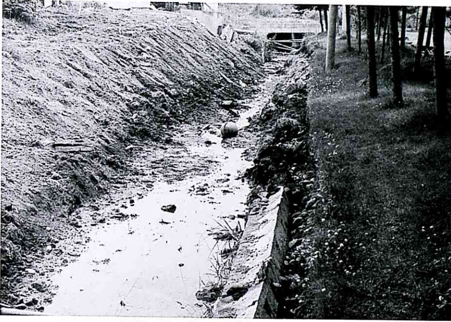
写真-32 グランド北側の用水路の破損
