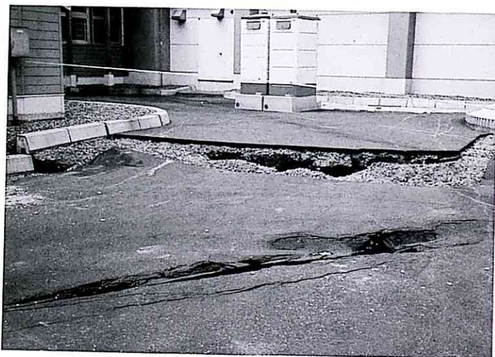
写真-20 前庭アスファルト舗装部の陥没
