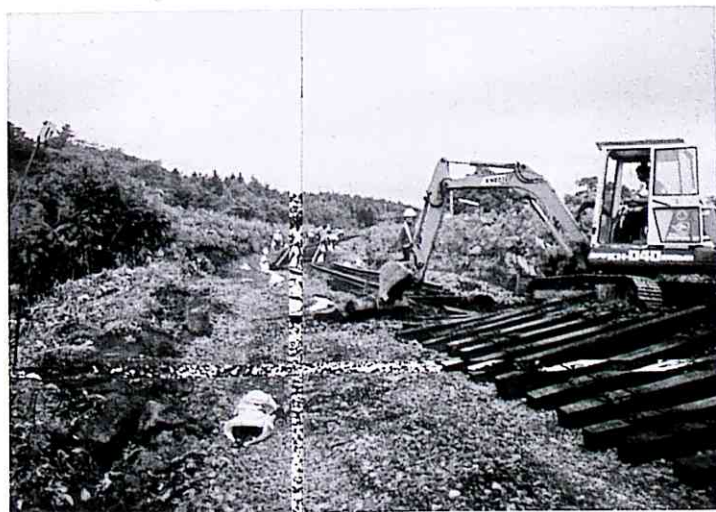
写真-17 同上に隣接したJR線路の変状
