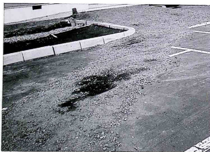
写真-3 前庭アスファルト舗装部のクラックと陥没
