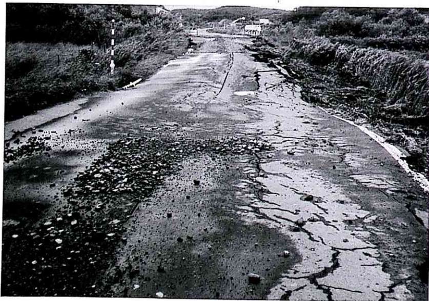
写真-4 北檜山町兜野の町道、車道の陥没
