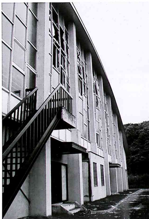
写真-5 長万部町文化センター。体育館ガラス枠のはらみ出し
