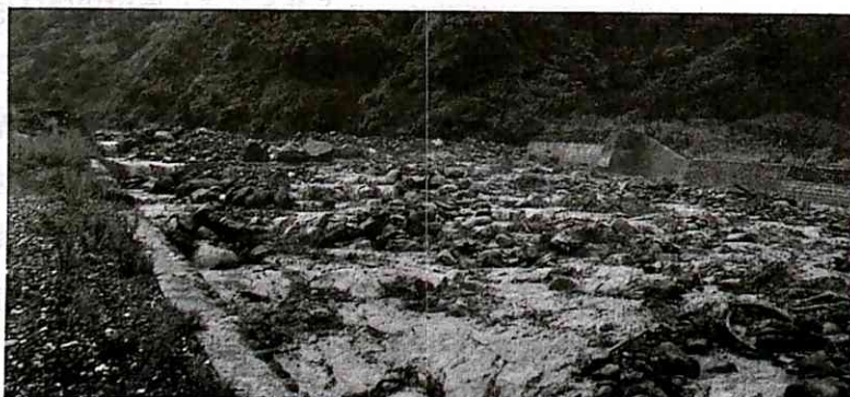
写真-3 笹倉温泉付近流路工の堆積状況
