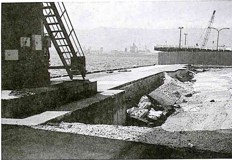
写真-16 岸壁背後の陥没
