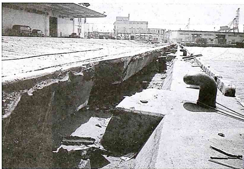
写真-15 橋詰西側岸壁の被害
