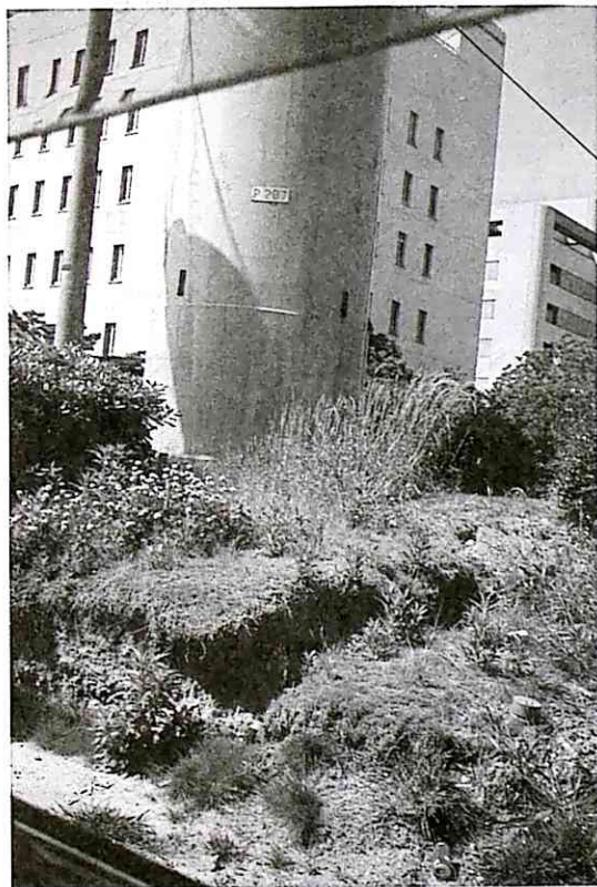
写真-2 ポートアイランド線支柱の浮上
