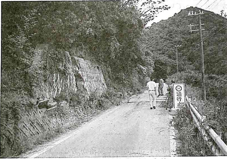
写真-23 土留壁の変状
