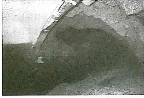
写真一六 天端崩落
