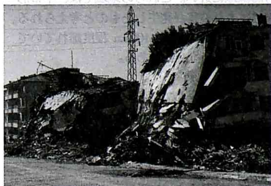
写真-6 DERINCE/谷地形部のビル倒壊状況
