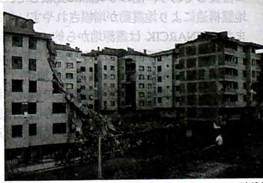
写真-7 BAHCECIK/震源地から 2 km 以内のビル倒壊状況
