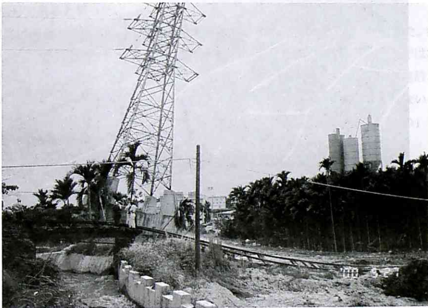
写真.3 送電線鉄塔の傾倒と集集線鉄道の寸断
