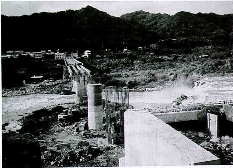
写真.1 地震断層により落橋した埤豊橋と河床に出現した8mの滝
