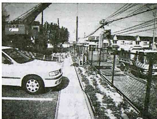
⑧自吸式ポンプ設置状況
