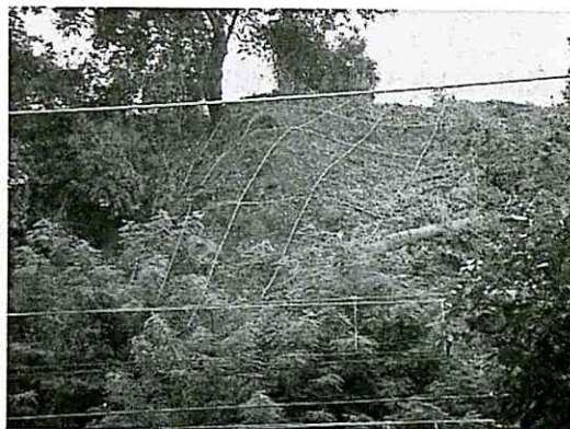
写真7 JR西日本・北陸本線落石防護網
