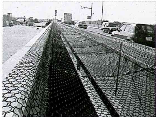
写真5 国道116号線新川橋・落下物防止網
