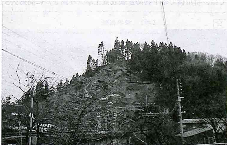
写真1 新潟中越地震 JR東日本・上越線「複トンネル」の災害復旧に高耐久STKネットを施工
