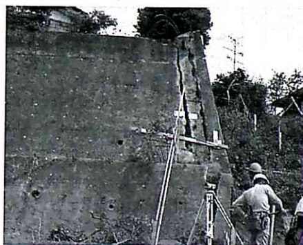
写真1 施工前擁壁被災状況
