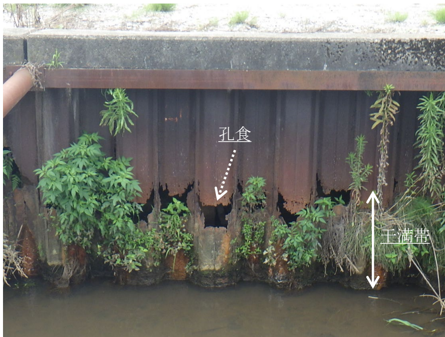
図 1-4 農業用鋼矢板護岸における孔食
