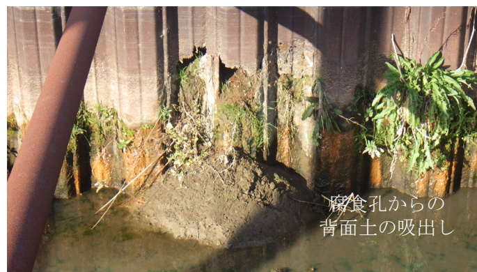
(a) 腐食孔からの背面土の吸出し
