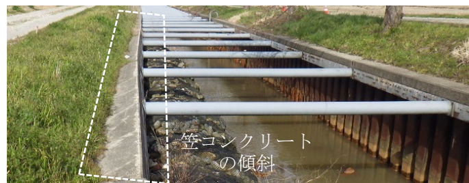
(b) 護岸の座屈による笠コンクリートの傾斜
