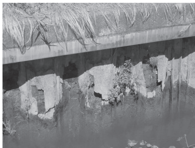
図 1. 農業用矢板水路の末期的腐食状況
