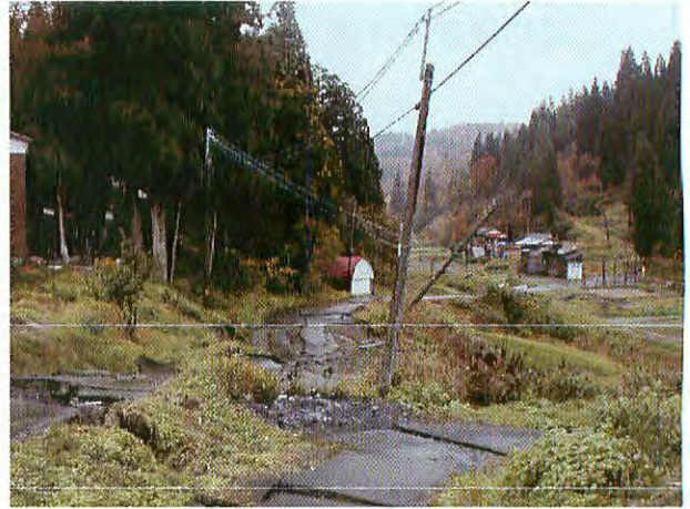
B) 路盤の谷部への崩壊.
