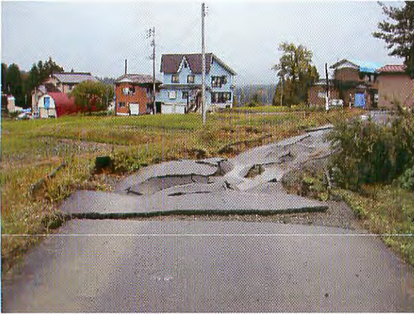
A) M1 段丘面上の路盤の亀裂.
