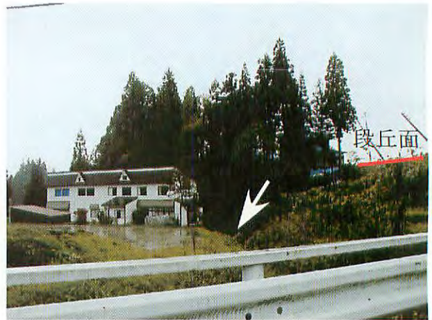
D) 建物被害は、段丘面の縁辺部にも多く見られる(M2 段丘面上)、段丘崖の崩壊などともない、縁辺部に立地する建物(木造二階建て一般住宅)の基礎部分(矢印方向)に破壊が起きている。
