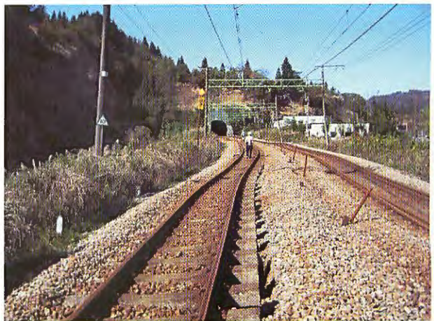
写真-2 JR上越線、北堀之内駅西方の路盤の変状。和南津トンネル坑口まで200~300mの区間で地盤の液状化により、線路路盤が変形している。
