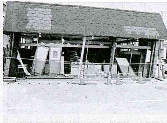
写真4 木造店舗構造・住家の全壊 (旧門前町門前地区)
