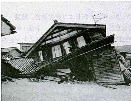
写真1 木造住家の倒壊(旧門前町道下地区) 基礎は礎石建ちタイプであった。
