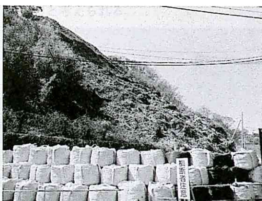
写真10 海岸沿いの国道での表層崩壊
